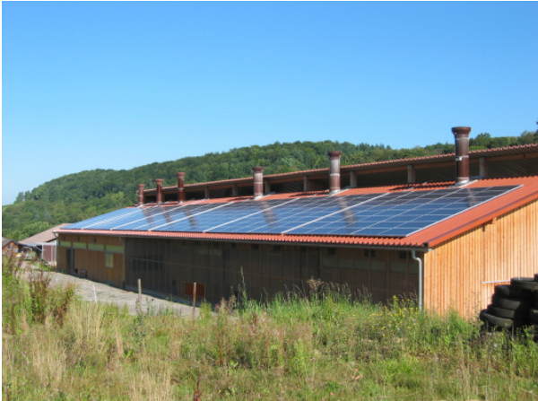
PV-Anlage auf einem landwirtschaftlichen Gebäude
